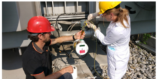
Preverjanje in kalibriranje senzorjev sprotnega nadzora transformatorjev
